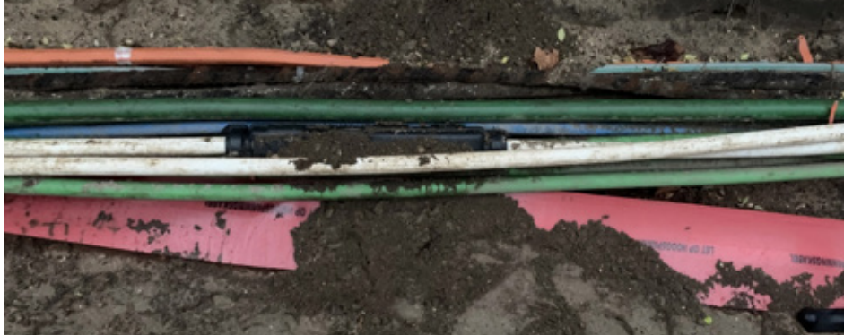
Schade aan kabels, ontstaan tijdens uitvoering van een werk
