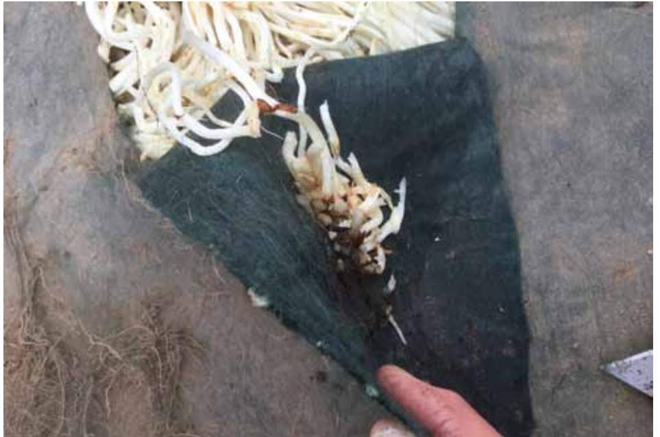
De wortels van de japanse duizendknoop onder het doek.
