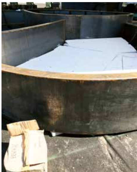
Bakken met piepschuim als gewichtsbesparing. Hier bovenop wordt het substraat gestort. Foto: Nophadrain.
